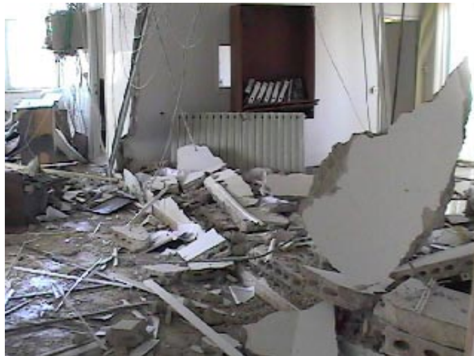
Zerstörtes Ministerium, Ramallah 2002
